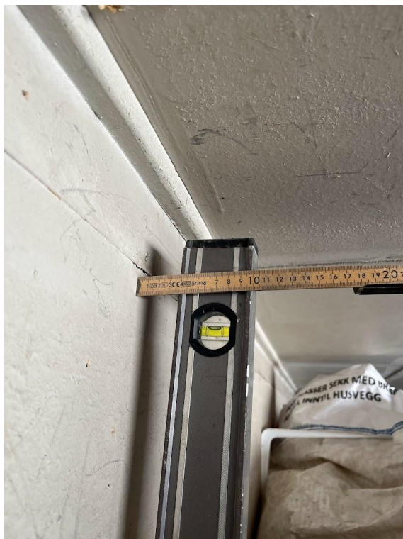
Bakvegg heller på det meste 3,5 cm. Bakover på 1,2 meters høyde. Denne garasjen har ingen utenforliggende terreng, så årsak til helling er usikkert. Det er mulig at denne veggen har «satt seg» for lenge siden og da ikke beveger seg noe mer, men vi mener veggen bør observeres over tid for kontroll over eventuelt videre bevegelse.
